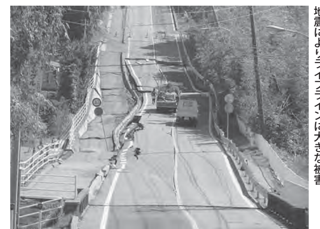
地震によりライフラインに大きな被害
